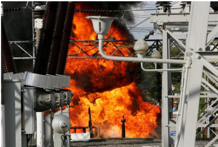
Figura 1. Explosão de transformador
